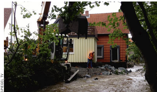
Aufräumarbeiten in Bad Harzburg
